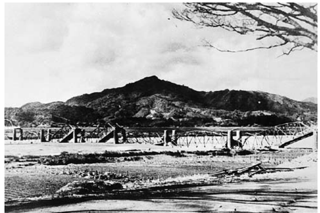
揺れによる橋の落下（9スパンのうち6スパンが落ちた。） 四万十市四万十川橋付近
