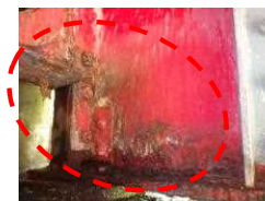
新大森橋の損傷状況
