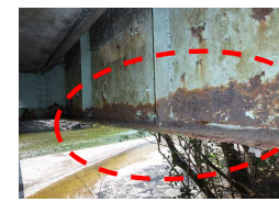
美舞橋の損傷状況
