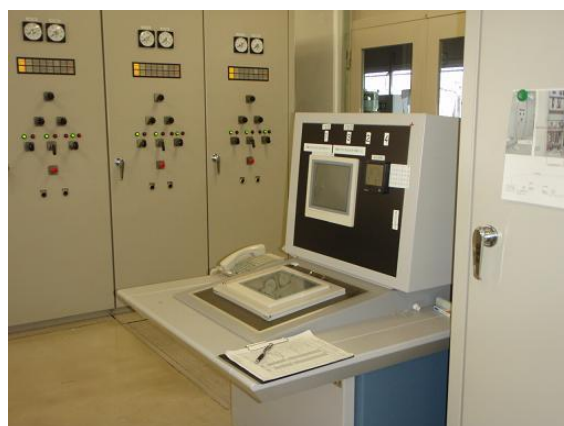
鏡川工業用水道 送水ポンプ操作卓
