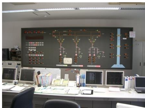
総合制御所 集中監視制御盤
