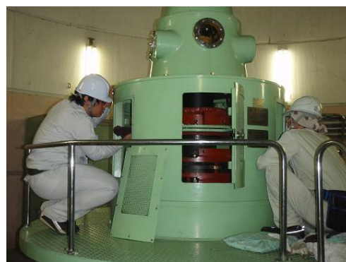
杉田発電所 発電機点検の様子
