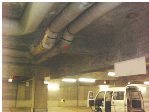
建物の天井に吹き付けられたアスベスト (吹き付けロックウール：飛散性)
