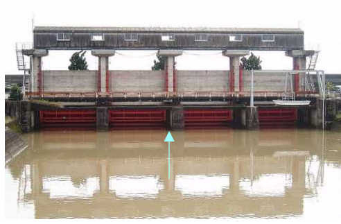
香宗川放水路防潮水門
