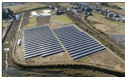
県内の太陽光発電施設
