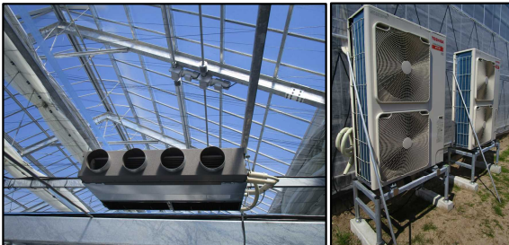
施設園芸へのヒートポンプ導入の様子
