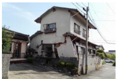
【熊本地震での住宅被害】
