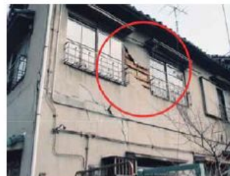
【半壊】 塗り壁では仕上の大半が剥離・脱落
