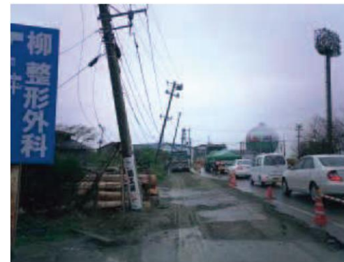
(左図) 2004年新潟県中越地震による電柱の沈下、傾斜と道路の性状
