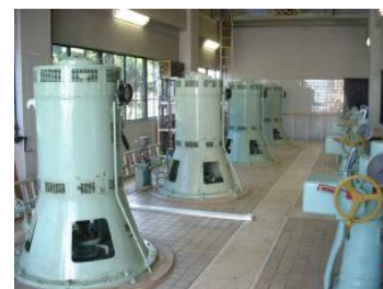
鏡川工業用水 送水ポンプ場
