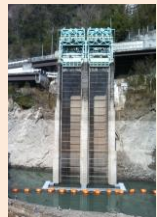
①除塵機レーキ
