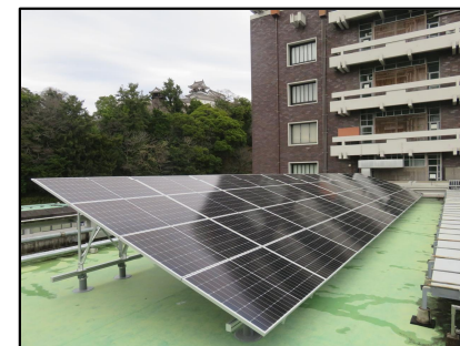
県庁本庁舎への太陽光発電設備の導入
