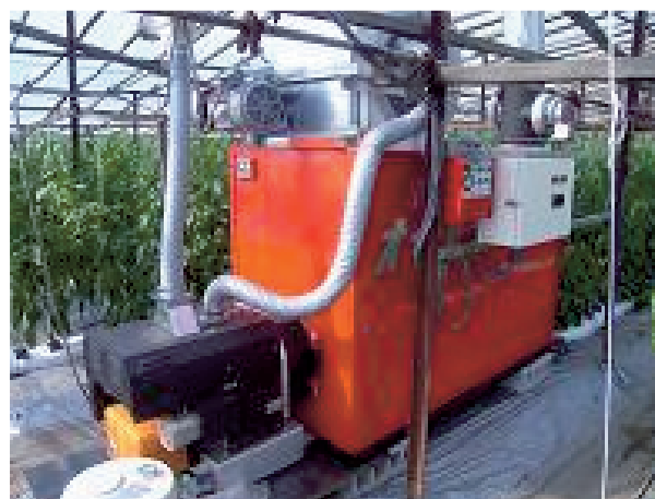
木質ペレットを燃料とするハウス加温機
