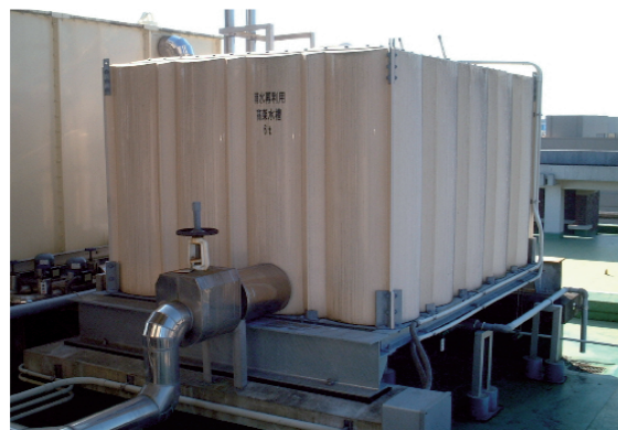
雨水利用高架水槽（本庁舎屋上）
