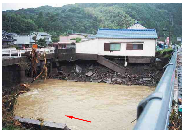
平成13年9月の豪雨による貝ノ川川下流域の被災状況
