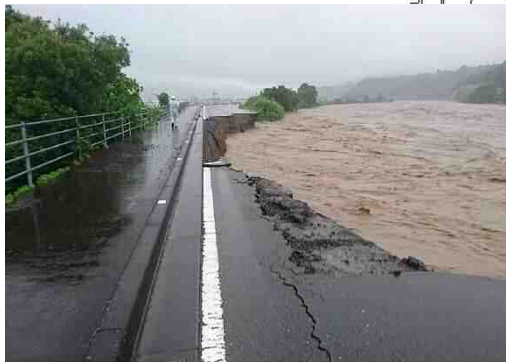
【写真：安芸川右岸（僧津地区）の被害状況（河岸・道路浸食）】
