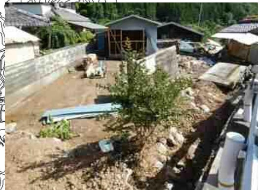
【写真：安芸川左岸（栃ノ木東地区）の被害状況（家屋全壊）】
