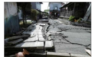
〔ブロック塀の倒壊〕
