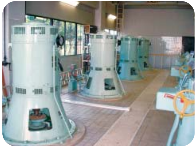
鏡川工業用水 ポンプ設備
