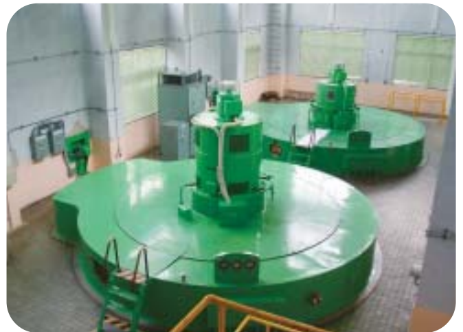
発電機（永瀬発電所）
