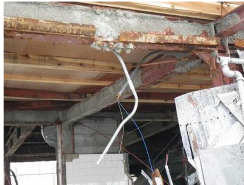
建物に残存した吹付け材
