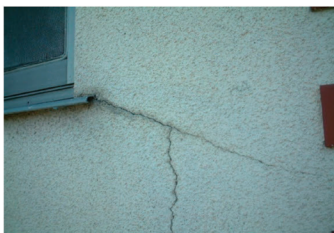
外壁モルタルの亀裂
