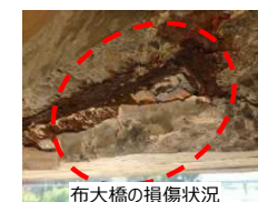
布大橋の損傷状況
