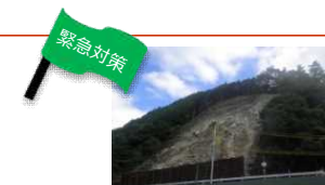
安田東洋線 (安田町平瀬地区)
