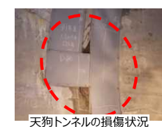
天狗トンネルの損傷状況
