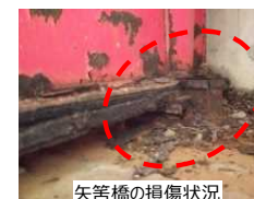
矢筈橋の損傷状況
