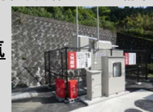
非常用電気供給施設
