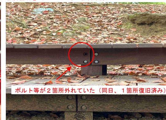
被害箇所③ (ベンチ: 4/23被害確認)
